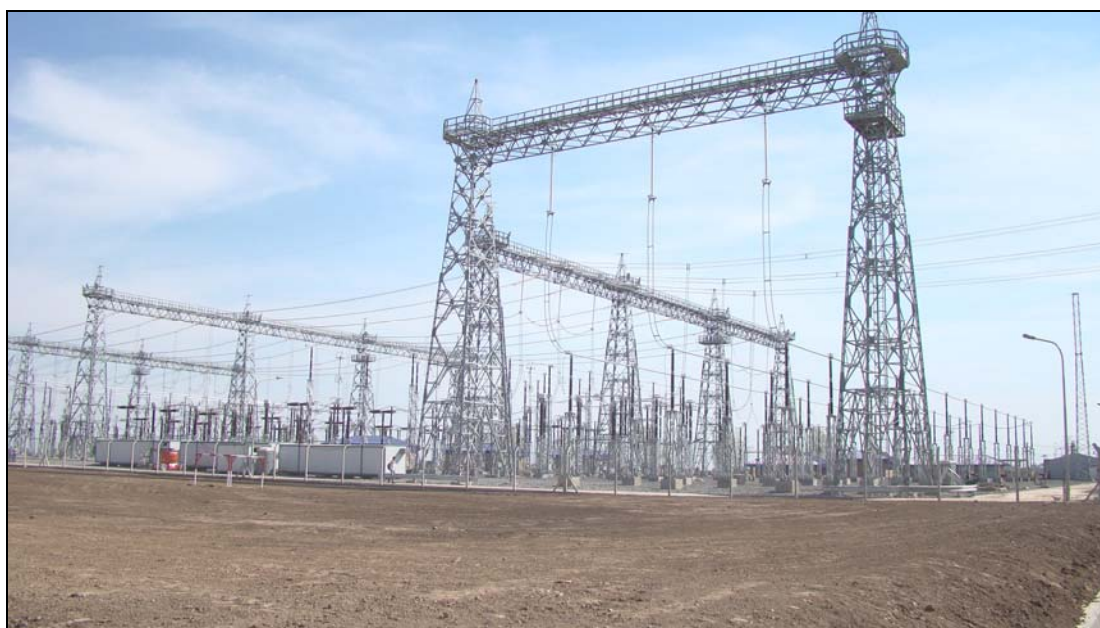
Playa de 500 kV en Complejo Nuclear Atucha, Buenos Aires. Foto: Ricardo De Dicco, Agosto de 2011.
